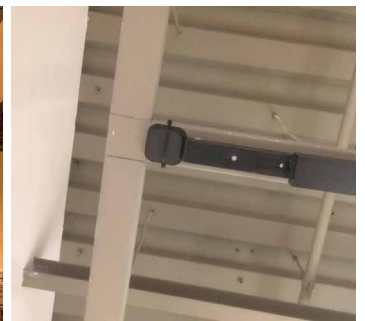
▲ 店内にはBeaconを約150個設置している。
